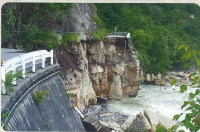
▲7月の豪雨災害で崩落(被災直後)。
